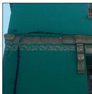
Detalle de la moldura que falta y tendido eléctrico que desalojar.
